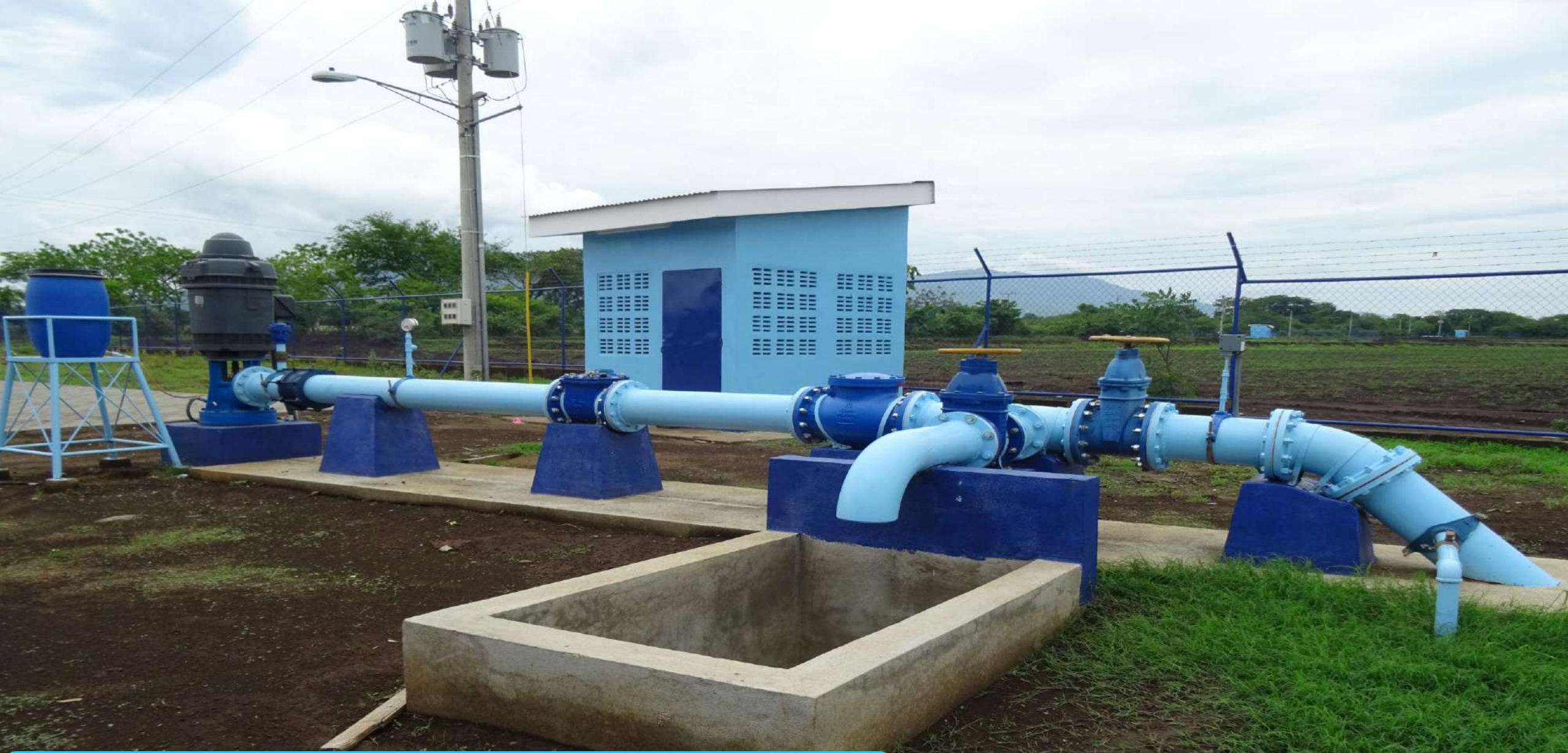
Sistema de Agua Chinandega
