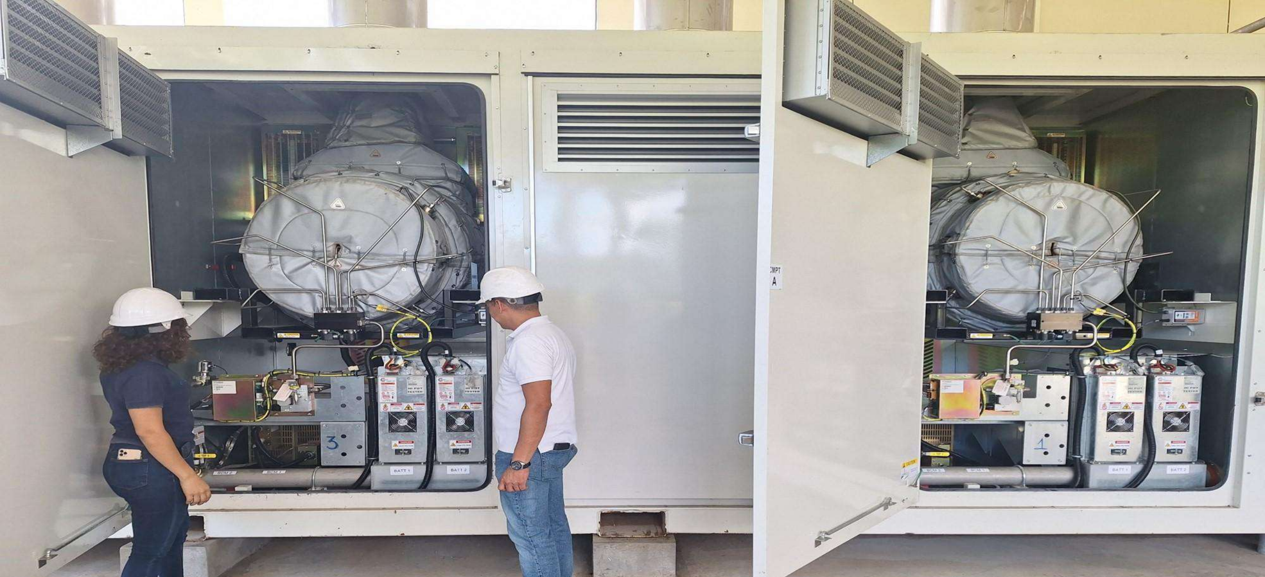
Planta Biogas- Managua
