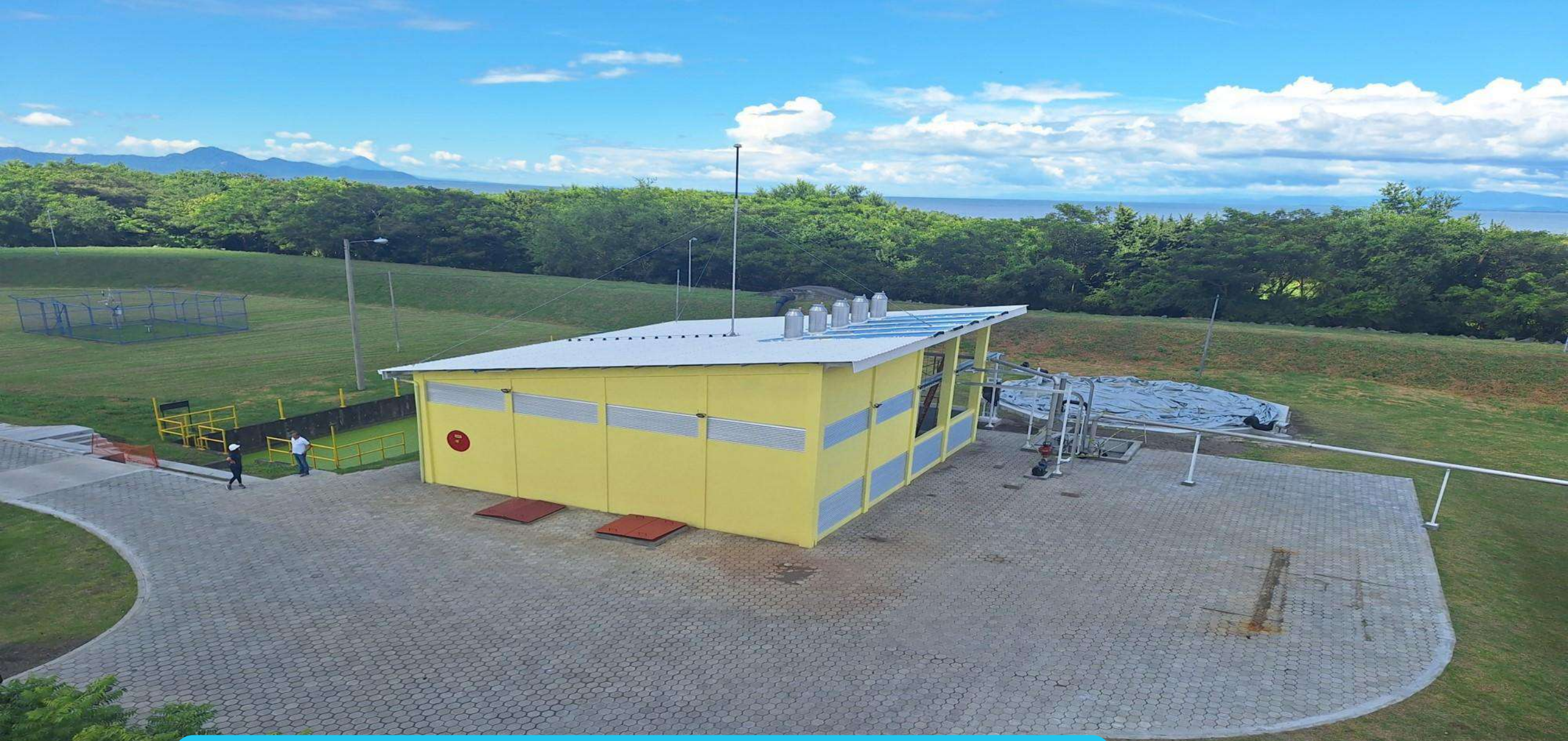
Planta Biogas- Managua
