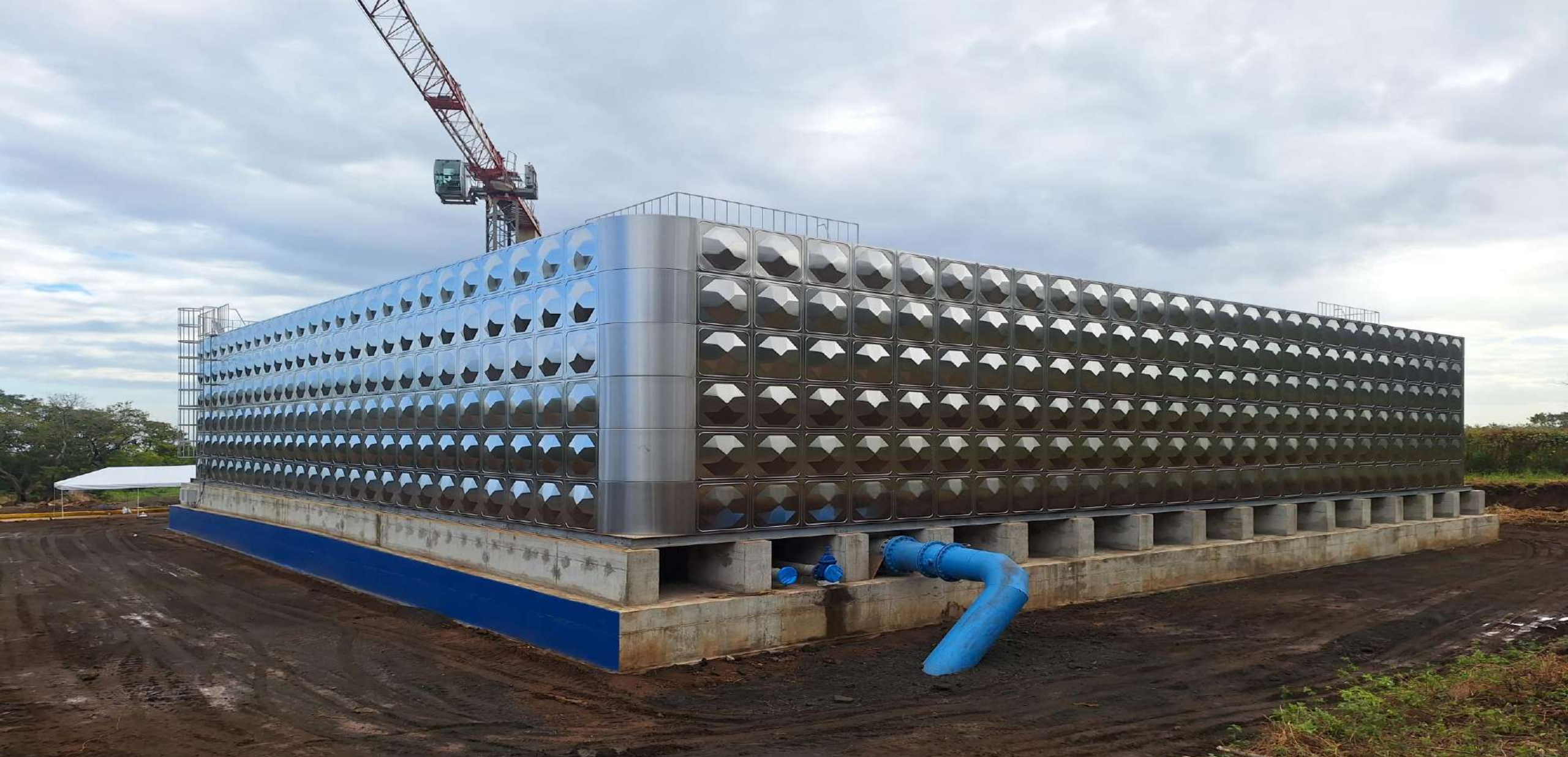
Tanque de Almacenamiento de Agua Las Pilas- JICA
